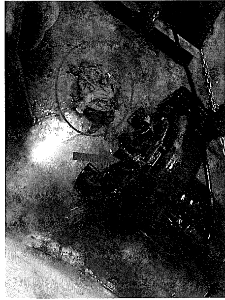
氣泵口內有大量消毒棉紙巾塞滿
