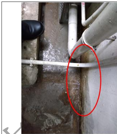
第3座泵房內地台湧水
