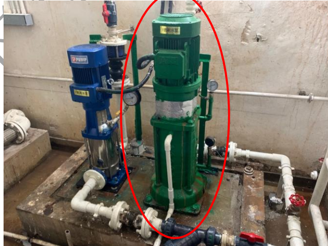
第1座地下1號廁水泵
