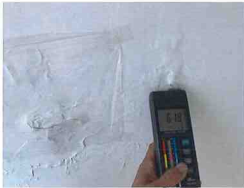
室內滲水位置 (1)
