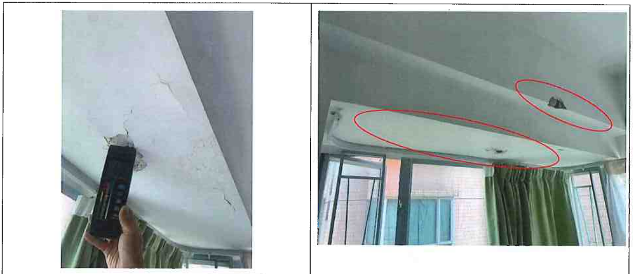
室內外牆滲水位置
