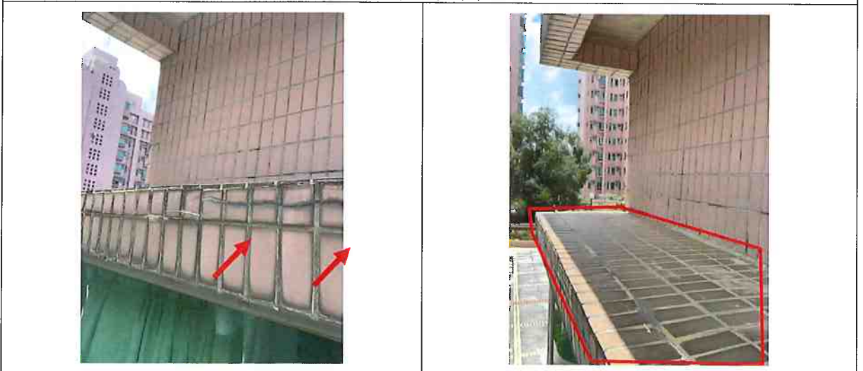
室外上窗台瓦片有裂痕(紅箭咀)
