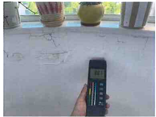
室內滲水位置(2)
