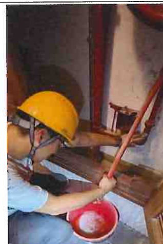
進行中(檢查各消防喉轆)
