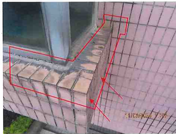
外牆瓦片有裂紋及空鼓情況
