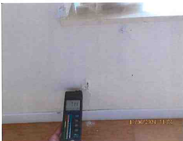
主人房室內牆身滲水位置
