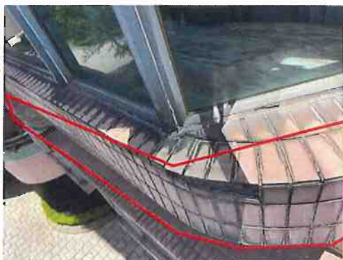
外牆瓦片鬆脫有裂縫
