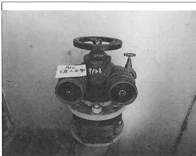
更換 2 座消防入水掣(更換前)
