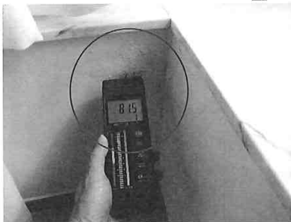
室內滲水位置
