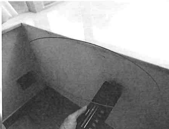
室內滲水位置
